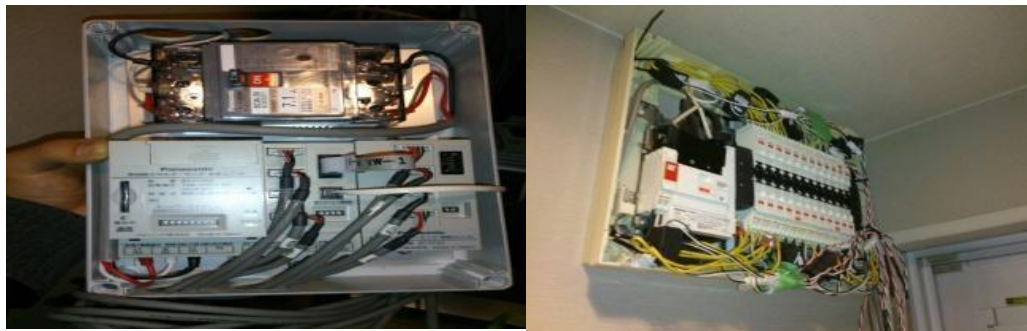
図 4.1-2 エネルギー計測システム設置状況
