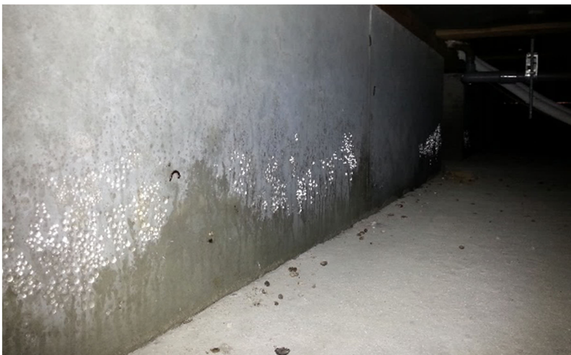
(b) 床下内部の基礎立ち上がりでの結露
