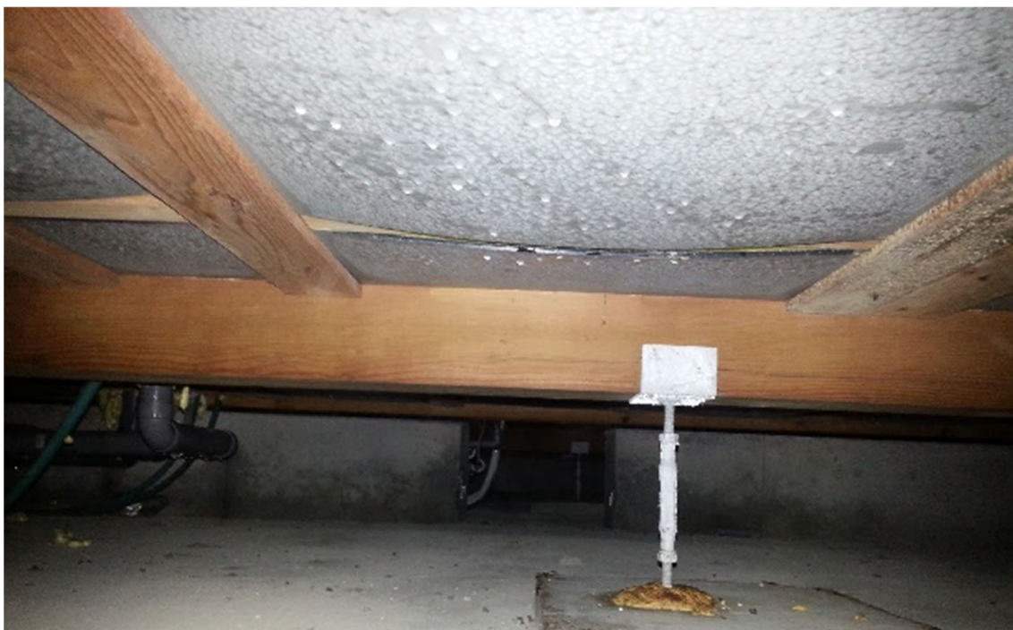
(a) 床断熱材を支えるボード表面での結露
