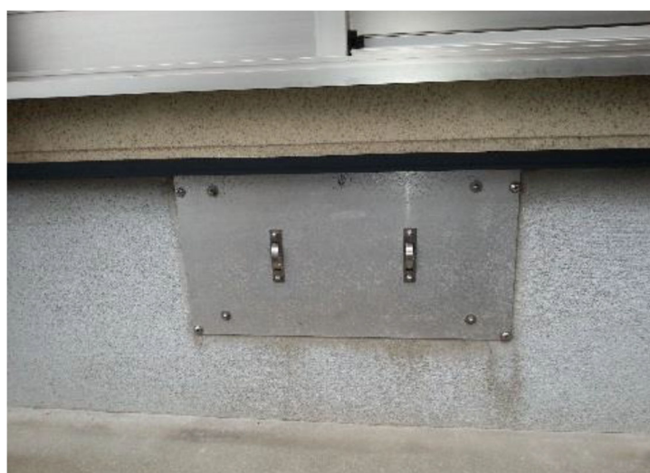
写真 4.2 O邸の開閉可能な換気孔
