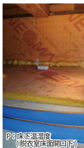
写真 4.4 2020年N邸各実測ポイントの機器設置時の様子 (J~P)
